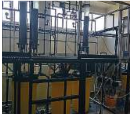
Figura 1. Filtros de carbón activado con los que cuenta la planta tratadora de aguas residuales del Instituto Tecnológico de Toluca
